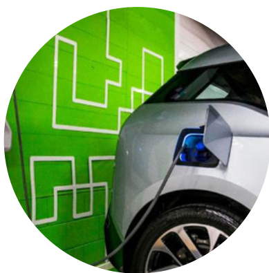
Carregador para veículos elétricos
