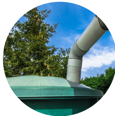
Reuso de águas das chuvas para irrigação das áreas verdes
