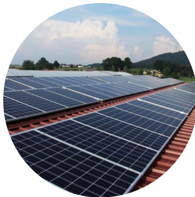
Energia Fotovoltaica em todas as áreas comuns
